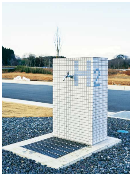
道の駅の燃料電池からは、電気と熱が発生する。この蛇口からは、その熱を利用した温水が出る
